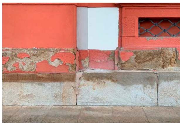
Havarijní stav soklu před započatím restaurátorských prací
