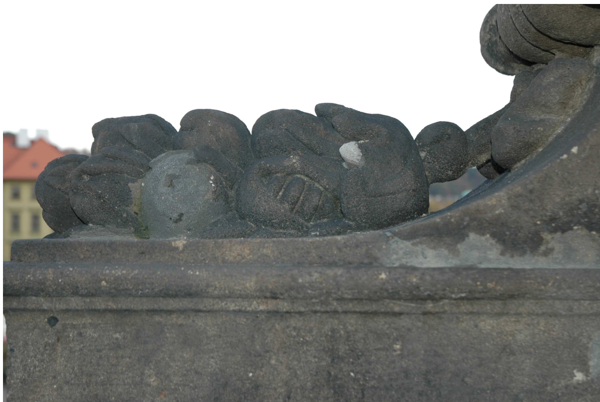
Nahoře nápis sprejem, dole koroze doplňků v tmelu, detail
