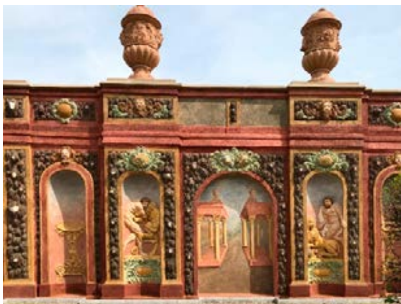
Stav východního prospektu po zimním období 2020–2021. Následek zvýšené vlhkosti spodních partií prospektu a působení mrazových cyklů. Detail poškození a stav po restaurátorské obnově soklové části, celkový pohled
