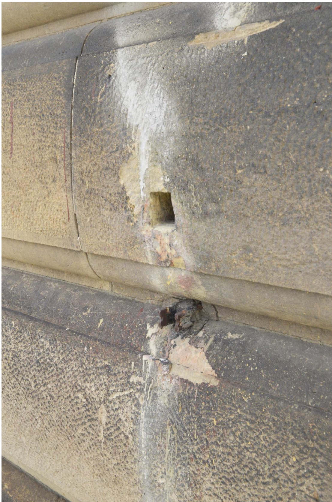
6. pozůstatky po uchycení původního oplocení, skvrny po nátěrových hmotách
