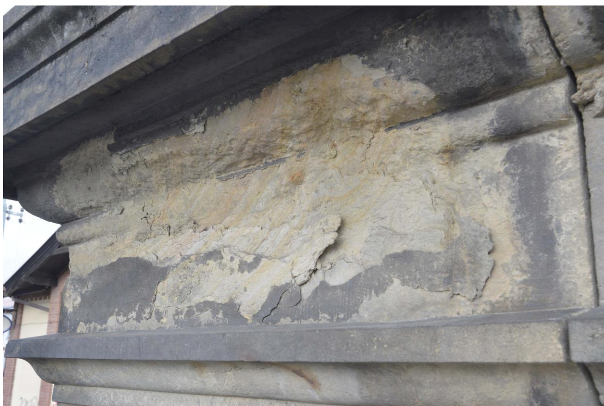
8. eroze kamene pod hlavní římsou podstavce
